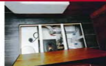
Bodenluken machen den Weg frei zur Unterflurinstallation.
